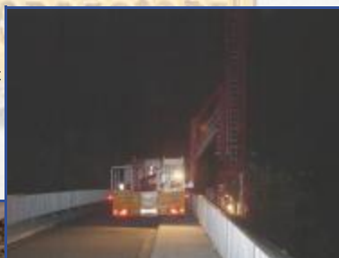
Brückenuntersichtgerät auf der Brücke ...
