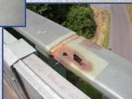
Korrosion am Geländer
