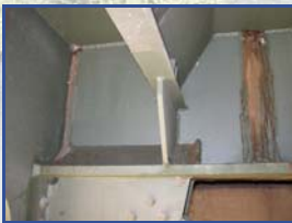
Undichte Fahrbahn- übergangskonstruktion
