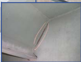
Schweißnaht- riss an der orthotropen Fahrbahnplatte
