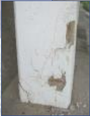
große Abplatzungen an den Stützen
